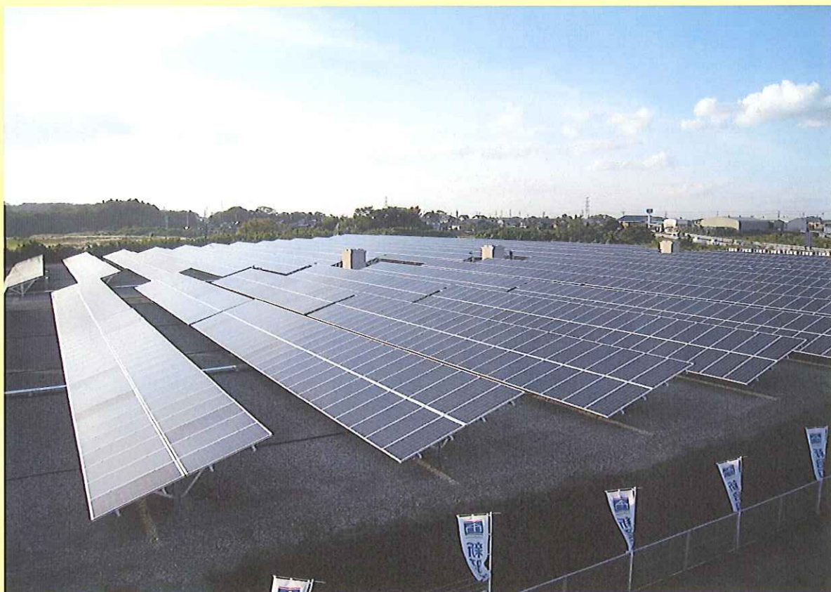
新昭和メガソーラー市原発電所（市原市山田）
